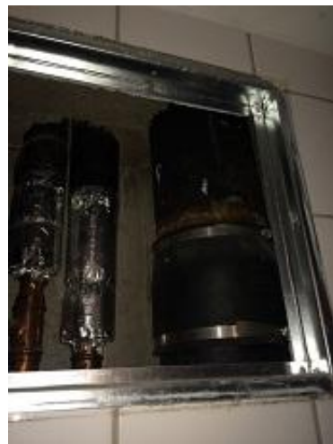
Påkoppling av rör bakom inspektionslucka
