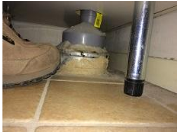
Gammalt gjutjärnsavlopp i golv
