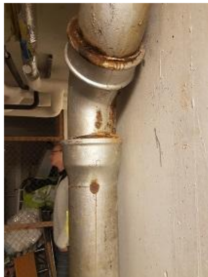
Rostigt avloppsrör i källaren
