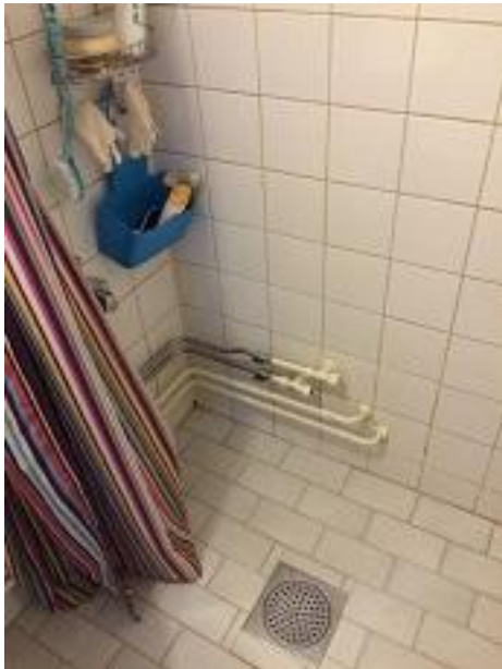
Rörlöpp i bad/duschplats
