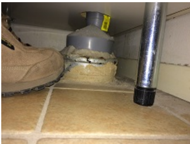
Gammalt avlopp av gjutjärn i WC
