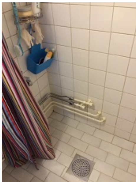
Rör genomföring i våtzon 1
